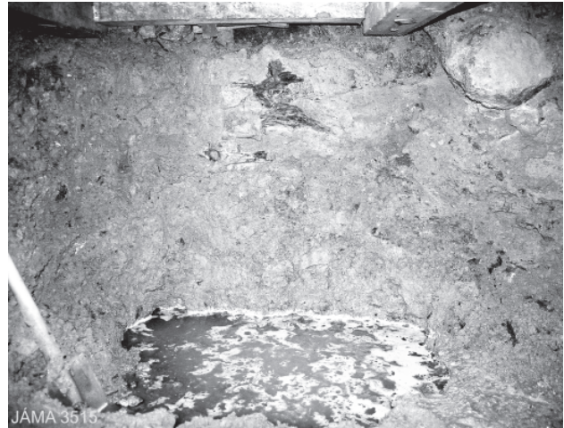
Obr. 62. Jáma 3515 v hloubce 12,5 m se silícím přítokem důlní vody (foto archiv ARCHAIA Brno).
