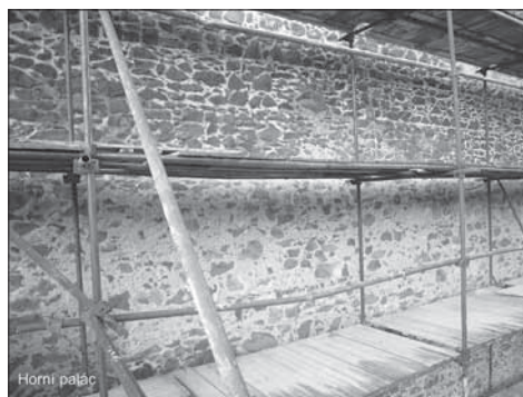
Obr. 13. Různý stupeň zachování malty ve spárách je při opravě respektován – ve spodní úrovni konzervované jádro omítky s lokálními opravami otevřených spár, v horní úrovni lokálně opravené spáry, nejvýše plošné spárování zdiva s maltou vyvětralou do hloubky. Abb. 13. Die verschiedenen Erhaltungsgrade des Fugenmörtels werden bei der Restaurierung respektiert – im unteren Niveau konservierter Putzkern mit stellenweisen Reparaturen offener Fugen, im oberen Niveau stellenweise ausgebesserte Fugen, ganz oben großflächige Verfugung des Mauerwerks, dessen Fugenmörtel bis in die Tiefe verwittert war.
