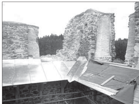
Obr. 17. Stříška horního paláce. Omítky v okenních špaletách nad střechou chráněny obezděním z cihel, koruna zdi kryta olověným plechem.
