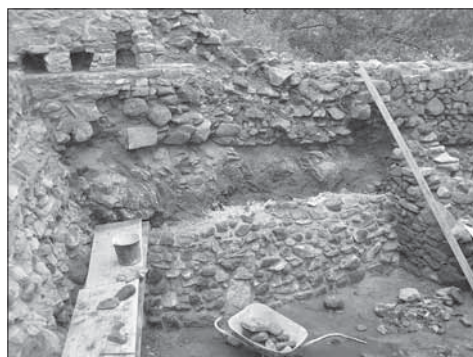
Obr. 12. Ochrana zvětralého skalního podloží přízdivkou s odvodňovacími otvory. Ve spodní části nová přízdivka, nad ní očištěná zvětralá hornina, výše rozvolněné základové zdivo. Abb. 12. Schutz des verwitterten Felsenunterbaus durch eine Vormauer mit Entwässerungsöffnungen. Im unteren Teil neue Vormauer, über ihr gereinigtes verwittertes Gestein, oben lockeres Fundamentmauerwerk.
