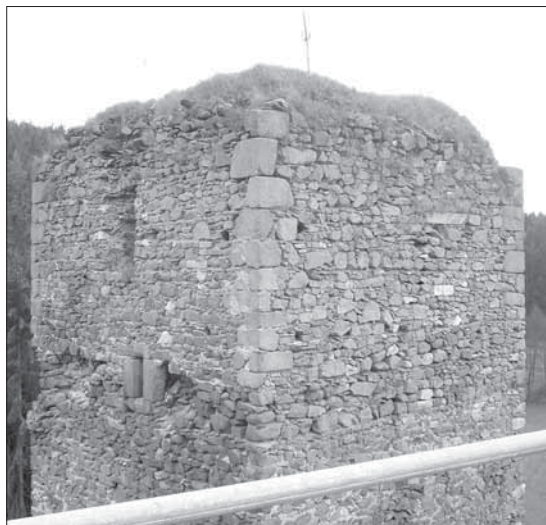
Obr. 20. Horní věž před opravou. Abb. 20. Oberer Turm vor der Restaurierung.
