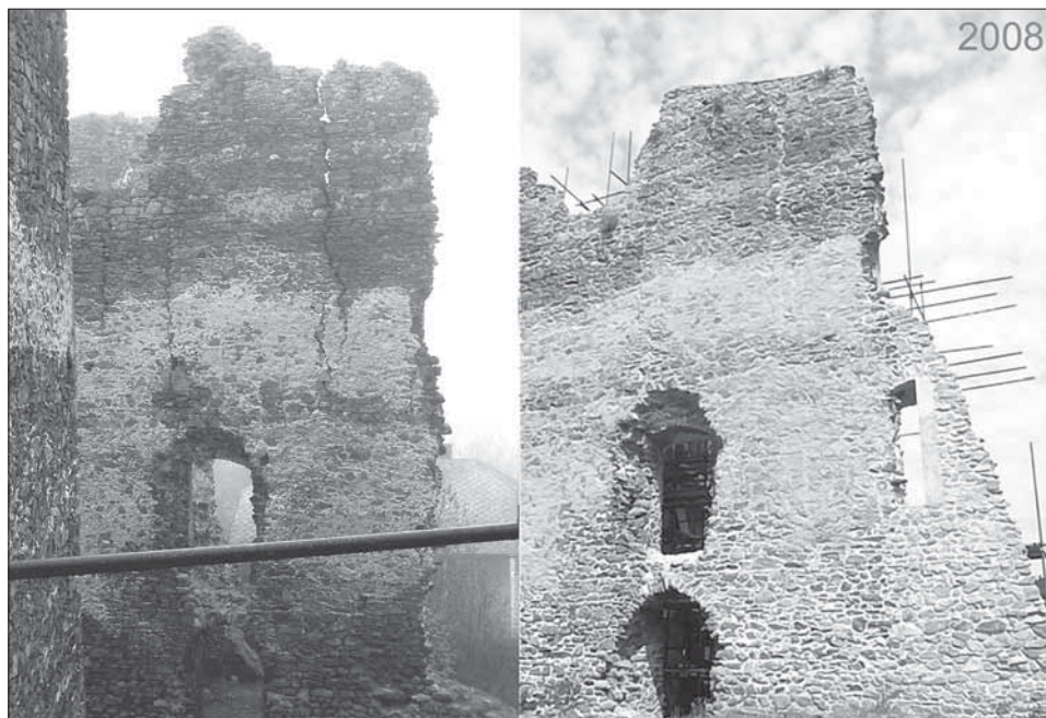
Obr. 14. Boční stěna horního paláce před opravou a po opravě. Zajištění trhlin, stabilizační opěrák, konzervace zbytků omítek, diferencovaný rozsah spárování.
