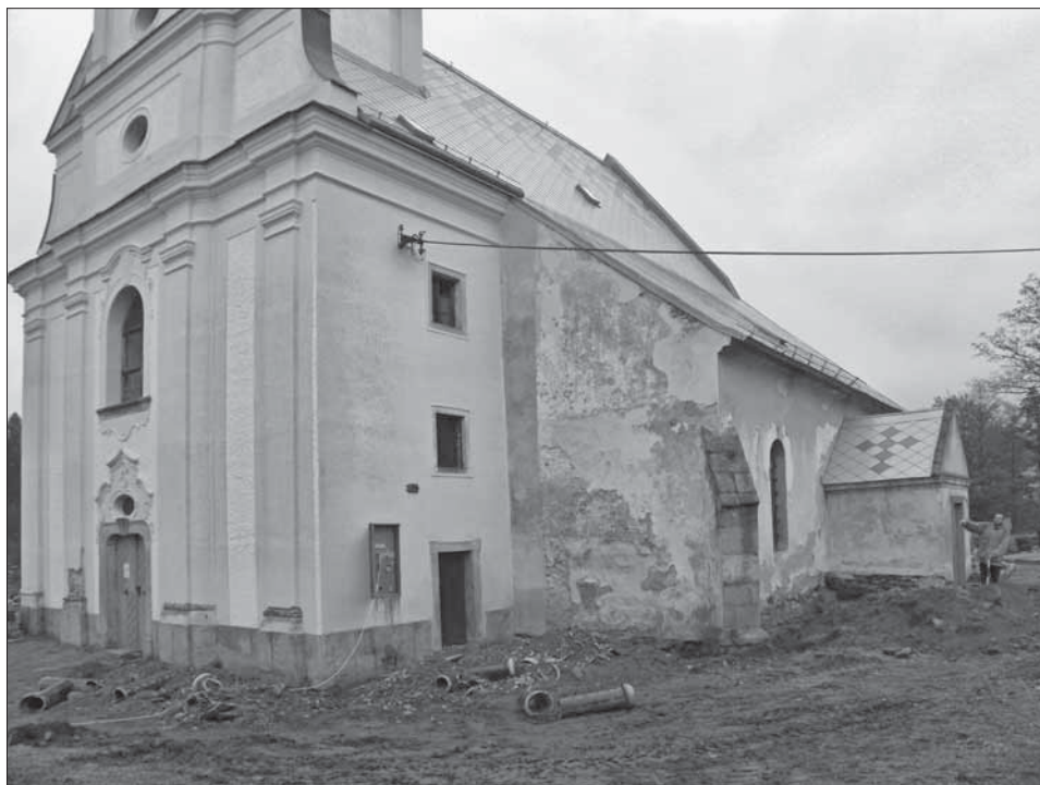
Obr. 19. Kostel sv. Petra a Pavla v Rančířově, pohled od jihozápadu. Foto D. Zimola.
