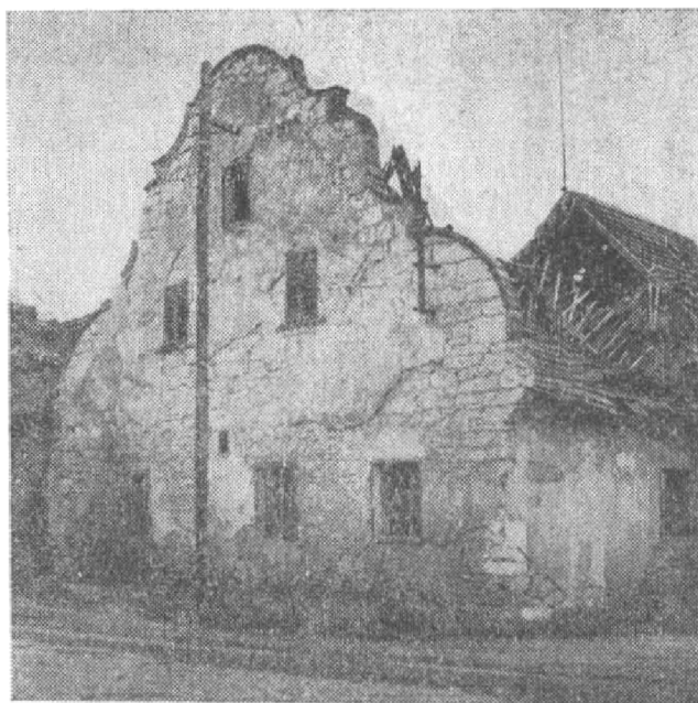
Obr. 9. Kluček čp. 33 (okres Louny), obytná část pozdně barokního domu usedlosti. V nároží je ve zdivu použita část pozdně gotického okoseného ostění. Foto J. Škabrada, 1978.
