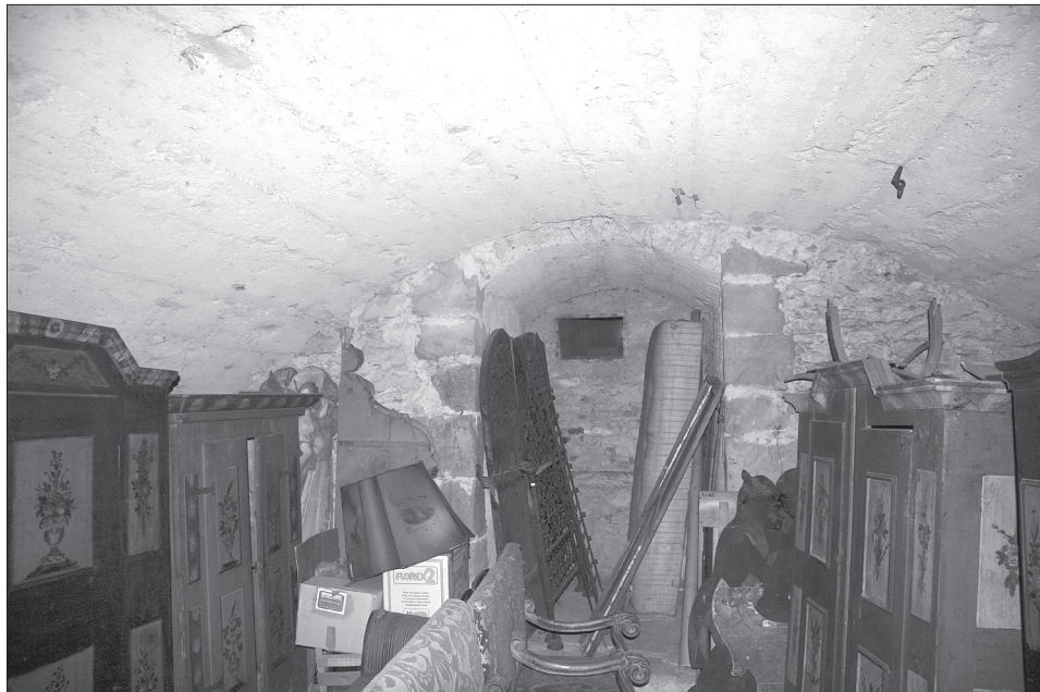
Obr. 12. První nadzemní podlaží obytné věže, levý hloubkový trakt, zazděný vstup vedoucí patrně na pavlač středověké komunikace a klenba s otiský po šalování do traktu vložena v průběhu 14. či 15. století. Foto I. Peřina 2006.
