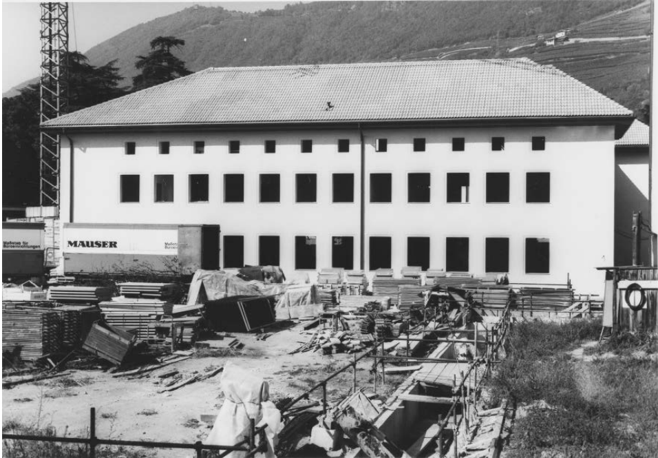
Abb. 4: Das Bozner Archivgebäude hier kurz vor dem Bauende 1985. Im Erdgeschoss ist die Landesbibliothek, im ersten Stock das Staatsarchiv und im zweiten Stock das Landesarchiv untergebracht. Die jeweiligen Depots befinden sich unter der Erde (Südtiroler Landesarchiv, Sammlung Presseamt, Nr. 1566).
