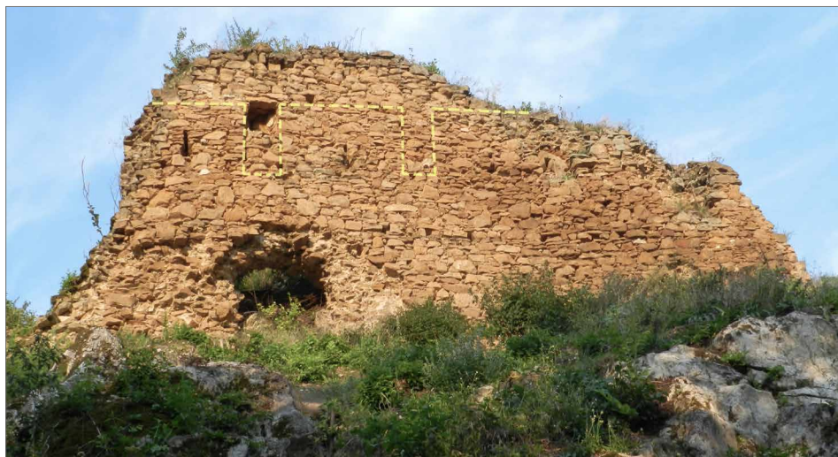
Obr. 12. Hrad Čičava, parkánový múr hradného jadra s vyznačením zamurovaného cimburia s kľúčovými strieľňami. Foto M. Bóna, 2016.
