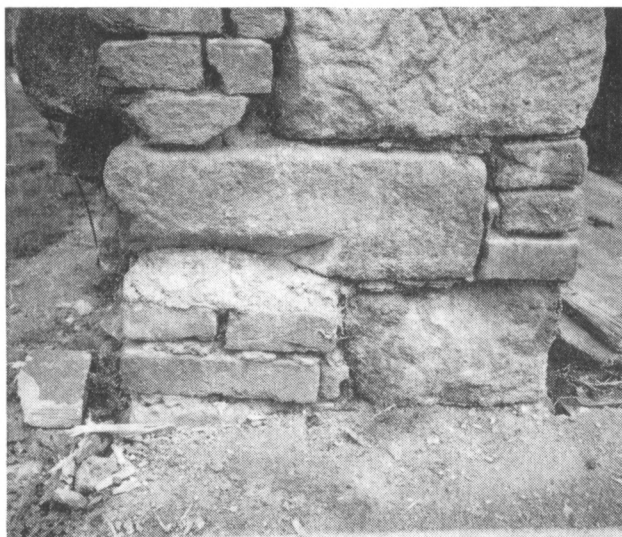
Obr. 7. Černice žp. 17. Zdivo u vjezdu do stodoly s částí oko- seného ostění.
