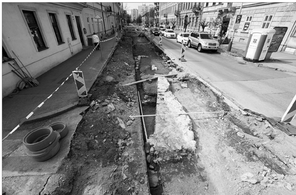
Obr. 11. Pohľad od východu na odkrytú situáciu s murivami polygonálnej veže vnútorného opevnenia, v pozadí s múrom situácie 4a napojeným na parkánovú hradbu.
