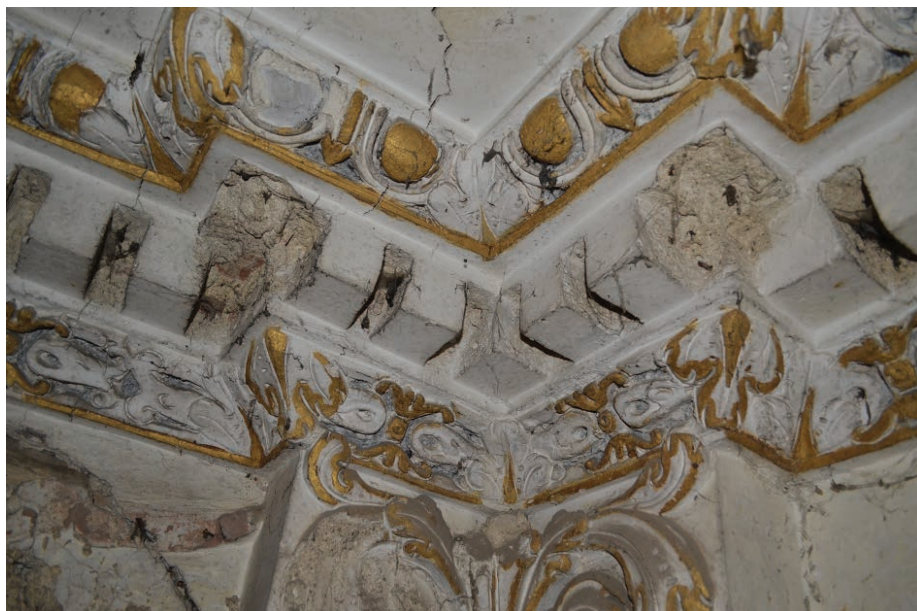
7) Zbytky výzdoby původního divadelního sálu zachovalé na půdě dnešní knihovny, detail výzdoby. (Foto autor)
