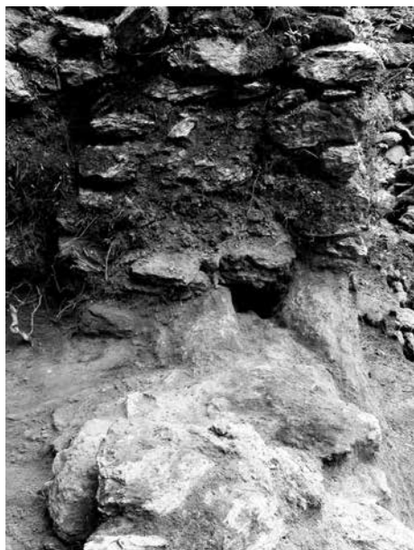
Obr. 4. Hrad Skály, okr. Žďár nad Sázavou. Východní líc zdi vstupu na převet s otvorem v úrovni podlahy.
