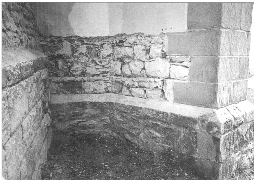
Obr. 8. Valašské Klobouky, děkanský kostel Povýšení sv. Kříže – detail nasazení diagonálního opěrného pilíře na JZ nároží lodi; skladba zdiva svědčí o současném vyzdívání lodi i pilíře. Vpravo kvádřová armatura pilíře, dole soklová římsa, vpravo druhotně přisazené zdivo věže, pohled od Z (foto: R. Vrla 2002).
