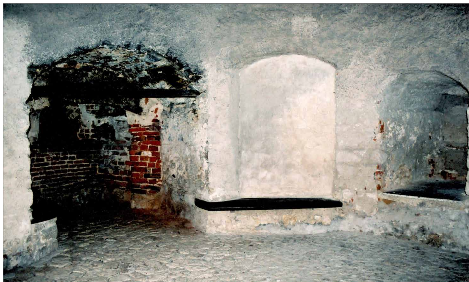
Obr. 9. Pieskowa Skała, Polská republika. Pec v průjezdu okrouhlé vstupní věže. Foto J. Varhaník, 2003.
