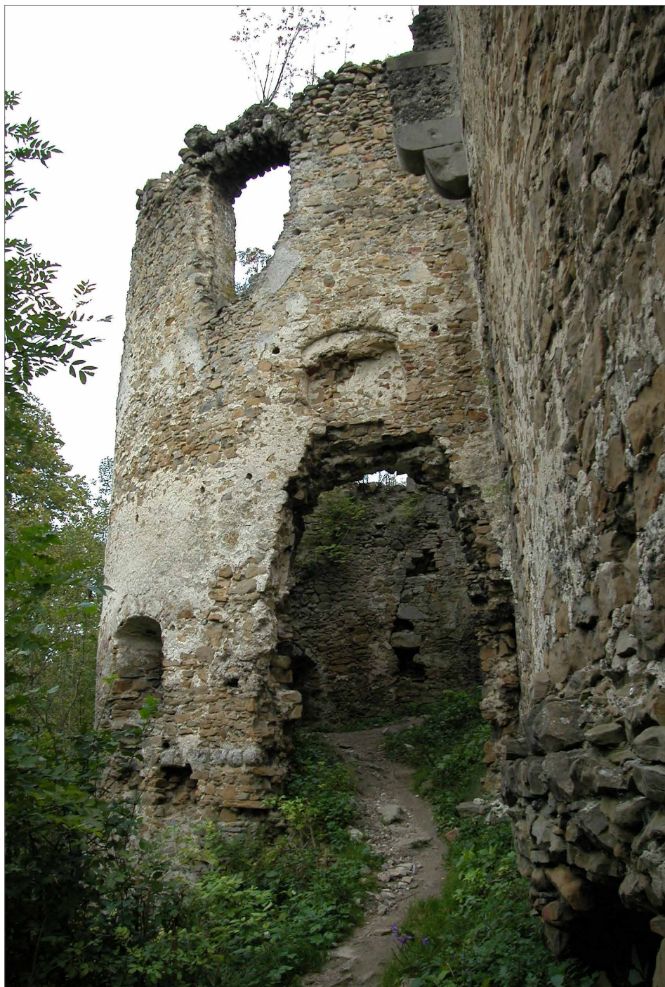
Obr. 7. Povážský hrad, Slovenská republika. Vstupní bašta z roku 1563. Stav před nedávnou obnovou, s vytrhaným ostěním brány. Foto J. Varhaník, 2004.
