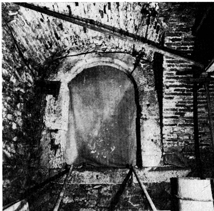
Obr. 9. Prepoštská 11 — vstupný portál do spodného podlažia; v pôvodnom otvore je osadená mladšia šambrána (15. storočie). Foto: V. Kamenická.
