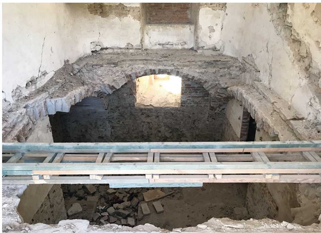
Obr. 24. Pohľad na prepadnutú podlahu v interiéri. (Foto D. Drobná)
