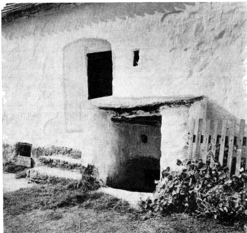
Obr. 18. Svěradice (okres Klatovy), sýpka v usedlosti čp. 3. Samostatná kamenná sýpka ve dvoře má oddělené nástupy do valeně klenutého suterénu a zvýšeného přízemí vlastní sýpky s trémovým stropem, původně ještě s lepenecem v podkrovní. Sestup do sklepa je opatřen šiji s bočními zidkami, přeloženými velkým plochým kamenem, který je podložen trémkem. Foto autor.
