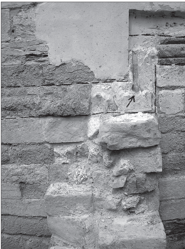
Obr. 12. Zbytok soklovej časti východného opieráku apsidy. Čiarkovanou čiarou je zvýraznený lom soklovej rímsy a šípkou odtok z rímsy (?).
