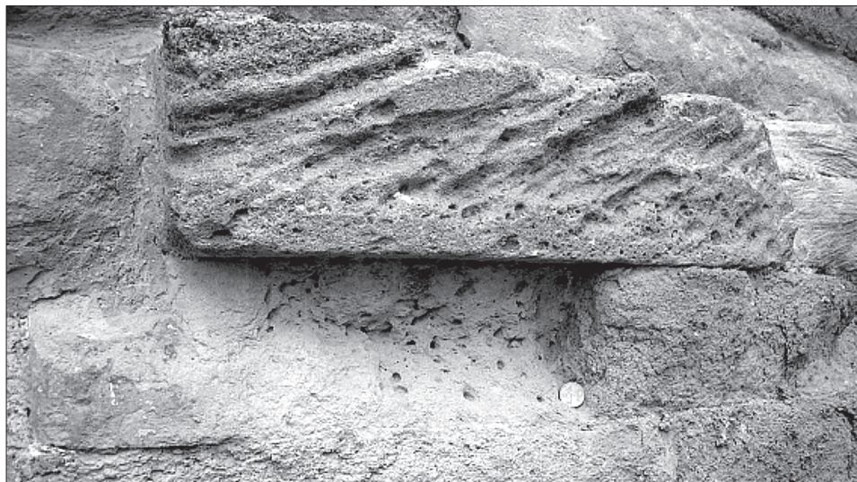
Obr. 6. Kvádre hore a dole v strede vytesané z pieskovcov. V hornom vidno šikmé zvrstvenie, čo je primárna textúra. V dolnom sa nachádzajú diery po vyvetraných úlomkoch, ktoré mohli vzniknúť i činnosťou organizmov. Južná strana apsidy.
