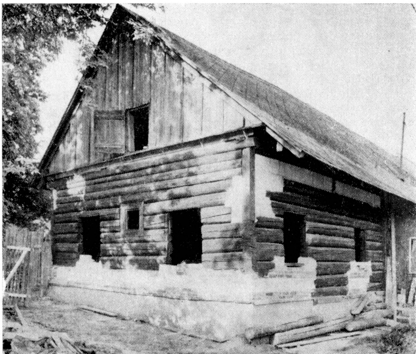
Obr. 1. Lučice čp. 2 (okr. Klatovy), celkový pohled na obytnou část domu po sejmutí hliněné omazávky a náhradě narušených prvků roubené konstrukce. Stav 1982.
