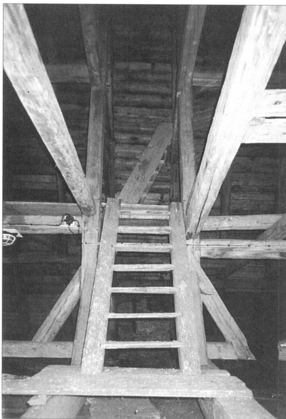
Obr. 17. Brantice, okr. Bruntál. Kostel Nanebevzetí Panny Marie. Mezera oddělující krov nad lodí (vlevo) od krovu nad presbytářem (vpravo) vzniklá vybouráním východního štítu lodí (D. Prix, 1999).
