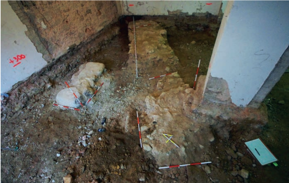
Obr. 7. Kremnica – Mincovňa Kremnica. Výskum v rokoch 2013–2014. Miestnosť A, pohľad od juhozápadu. Vpravo múr 5 – mestská hradba, vľavo múr 6 – západný múr barbakanu. Foto K. Kučeráková.
