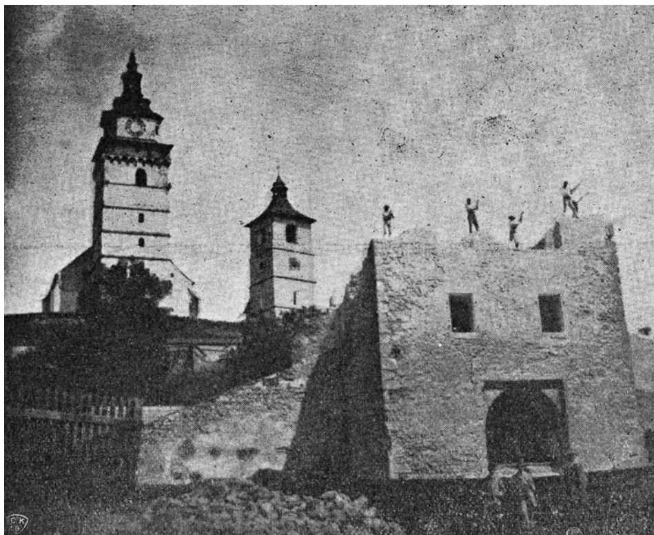
Obr. 5. Kremnica. Búracie práce na bráne barbakanu Hornej brány. Pohľad na juhovýchod. Zdroj kópie Múzeum mincí a medailí Kremnica, elektronická zbierka D. Kianička.
