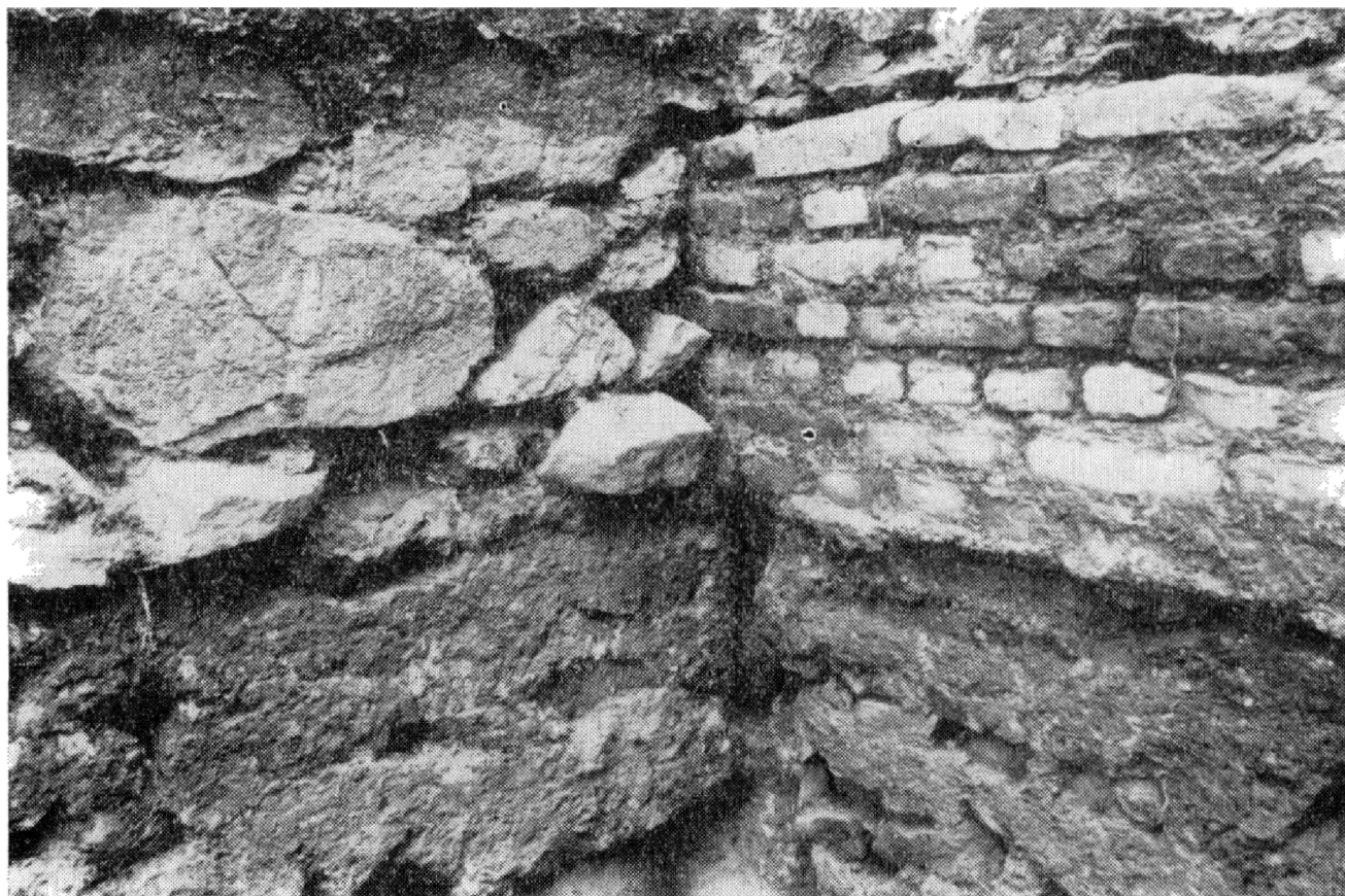
Obr. 9. Šamorin-Šamot. Špára v základovom murive sakrálnej stavby pri napojení sakristie.
