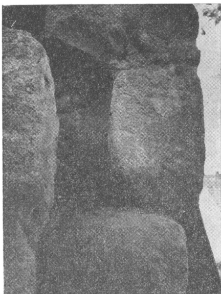
Obr. 13. Bolevec čp. 7. Detail rozpadajícího se zdiva severní brány do dvora usedlosti, vyzděné v 19. století s použitím tesaných článků pozdně gotického vjezdu podobného typu. Na snímku je patrná mohutná okosená konzola, která zřejmě podpírala trámový překlad vjezdu.
