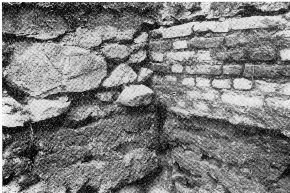
Obr. 9. Šamorín-Šamot. Špára v základovom murive sakrálnej stavby pri napojení sakristie.
