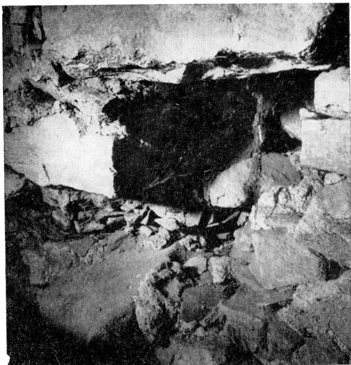
Obr. 3. Radošovice (okr. Strakonice) čp. 9. Situace štěpů u kapsy ve zdi- vu štítu.
