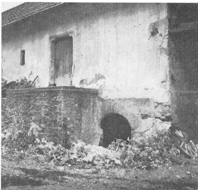
Obr. 3. Bražná (PB) čp. 6. Kamená dvoupodlažní sýpka se dvěma pozdně gotickými portály, původně možná zadní část obytného stavení. Stav 1981.
