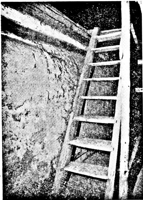
Obr. 6. Čistá čp. 171, horní část roubeného bloku jizby s izolační hliněnou omázkou, vyznívajícím do prostoru horní síně. Nahore vyrovnávací roubená ohrádka pro usazení krovu, vpravo schody na půdu. Foto J. Škabrada, 1988.
