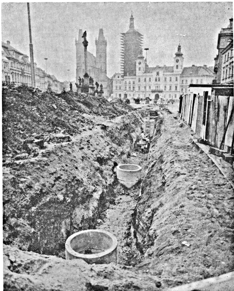
Obr. 1. Hradec Králové, Velké náměstí. Pohled na výkop pro kanalizaci od V (foto J. Beneš).
