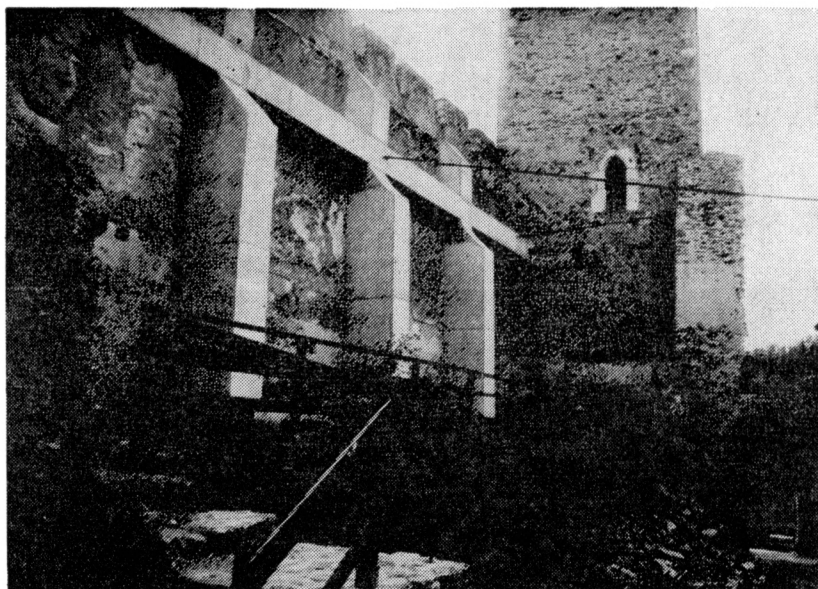
Obr. 7. Zřícenina hradu Kaja v Rakousku — necitlivé zabezpečení vykloněné hradní zdi kotvenými betonovými pilíři a věnoí, kombinovanými s ocelovými táhly.
