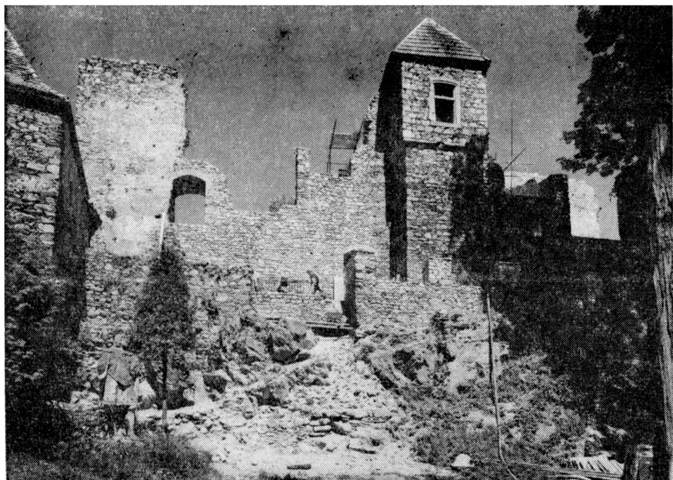
Obr. 1. Hrad Klenová u Klatov — příklad rekonstrukce nedávno zřícené části hradní kullsy, s vložením stabilizační dozdivky, pro níž byl hledán tvar, navazující na romantickou úpravu z 19. století.
