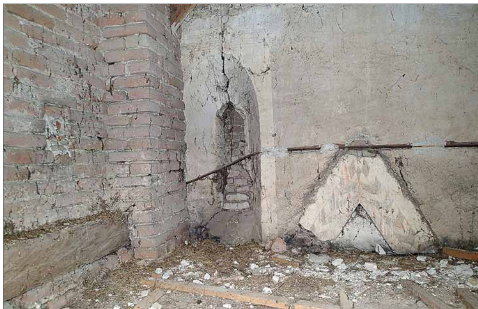
Obr. 14. Jednoduchý hranolový rám ukončený vimperkom nad vstupným otvorom s dodatočnou renesančnou výzdobou, vľavo pôvodné okno upravené v 15. storočí, kostol v Ružindole, južná fasáda, nálezy v podkroví nad dostavbou, 20. roky 14. storočia. Abb. 14. Einfacher, prismenförmiger von einem Wimperg abgeschlossener Rahmen über der Eingangsöffnung mit nachträglicher Renaissanceverzierung, links ursprüngliches, im 15. Jahrhundert geändertes Fenster, Kirche in Ružindol, Südfassade, Funde im Dachstuhl über dem Ausbau, zwanziger Jahre 14. Jahrhundert.
