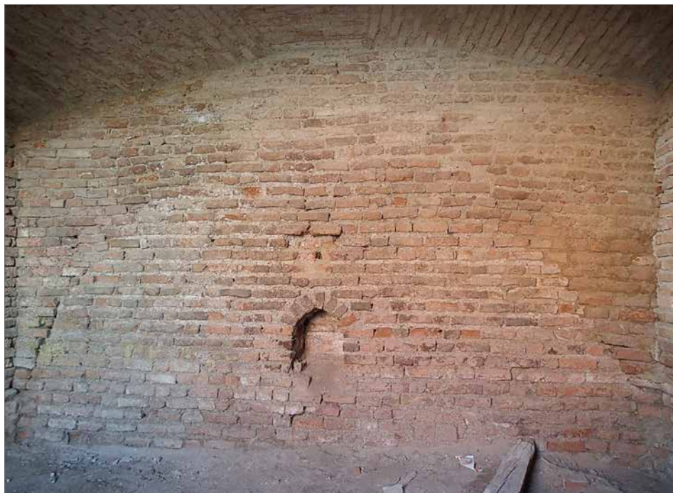
Obr. 2. Typický povrch rezného tehlového muriva prejavujúci sa absenciou väzby, meštiansky dom v Trnave, Halenárska ul. 14, pivnica.
