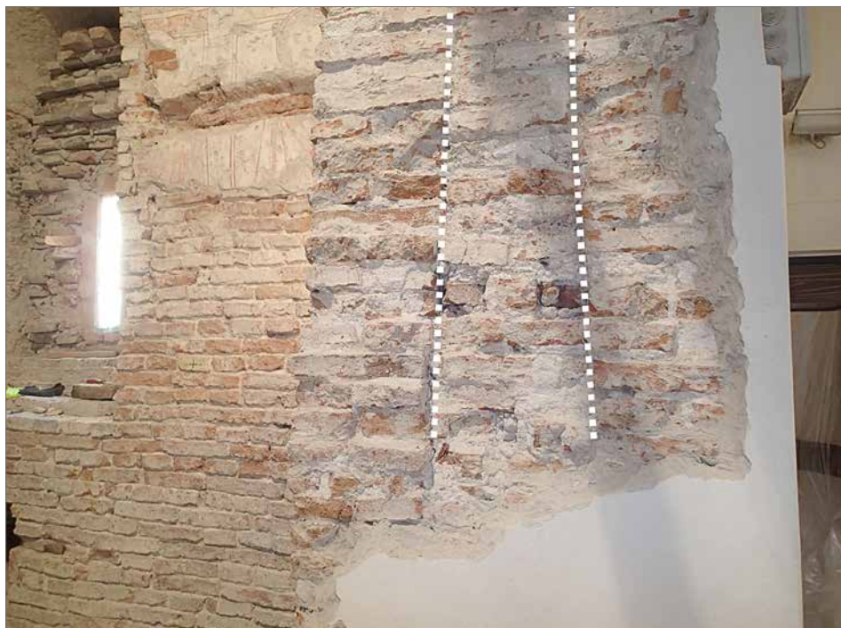
Obr. 24. Južná špaleta víťazného oblúka kostola v Malej Mači so zvýraznením trojice pilierov v reze muriva steny.
