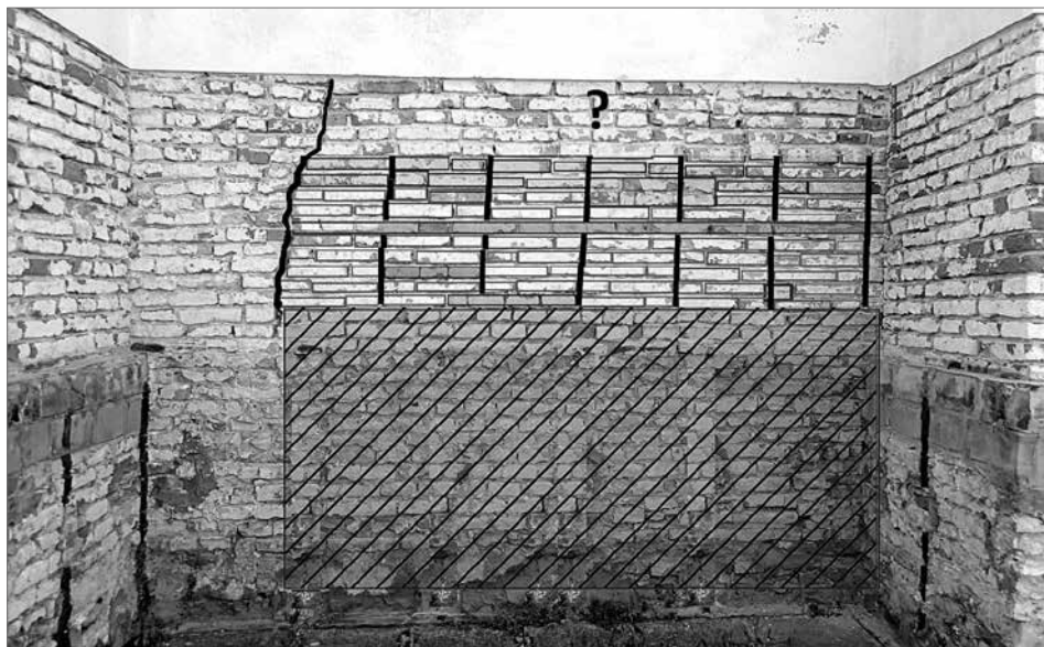
Obr. 23. Severná fasáda kostola v Hrnčiarovciach nad Parnou, časť plochy medzi b–c zobrazuje murivo prejavujúce sa „pilierovou väzbou“. Šrafovaná plocha – novodobá soklová premurovka.
