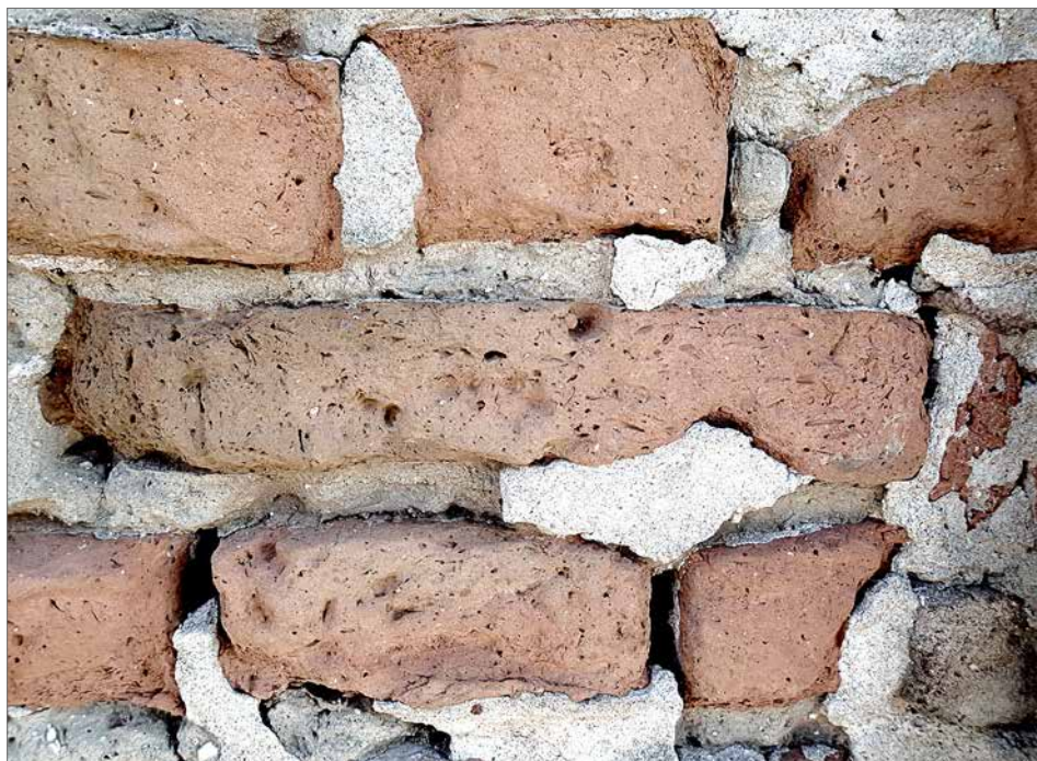
Obr. 17. Prierez plefovými tehľami so stopami po vypálených plevách a odrezkoch slamy, kostol v Čiernom Brode-Hegy, 1. polovica 13. storočia.
