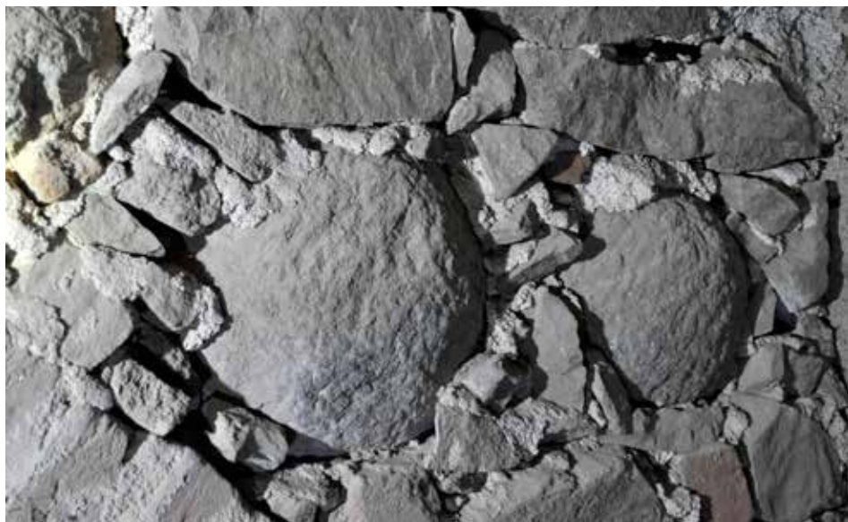
Obr. 12. Hrad Zvíkov, okres Písek. Zazděné projektily do bombardy v horní části břitové věže. Foto J. Varhaník, 2015. Abb. 12. Burg Klingenberg, Bezirk Písek. Eingemauerte Bombardenprojektil im oberen Teil des Prallkeil-Turms. Foto J. Varhaník, 2015.
