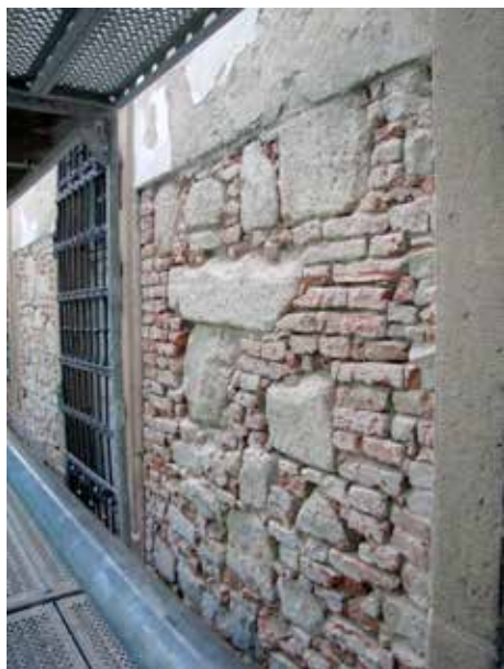
Obr. 2. Vizovice. Část spodní partie jižního průčelí zámku s obnaženou strukturou zdiva; v cihelném zdivu je použito velké množství starších architektonických detailů. Foto R. Vrla, 2013.
