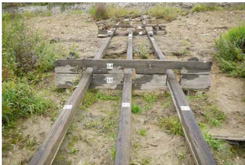
Obr. 6. Tábor – Jordán. Jižní spodní výpusť – tři svahová táhla procházela otvory v dřevěných lavicích, jež byly umístěny v několikametrových odstupech na svah návodní strany hráze mezi její korunou a převodovým mechanismem na spodním konci táhel.
