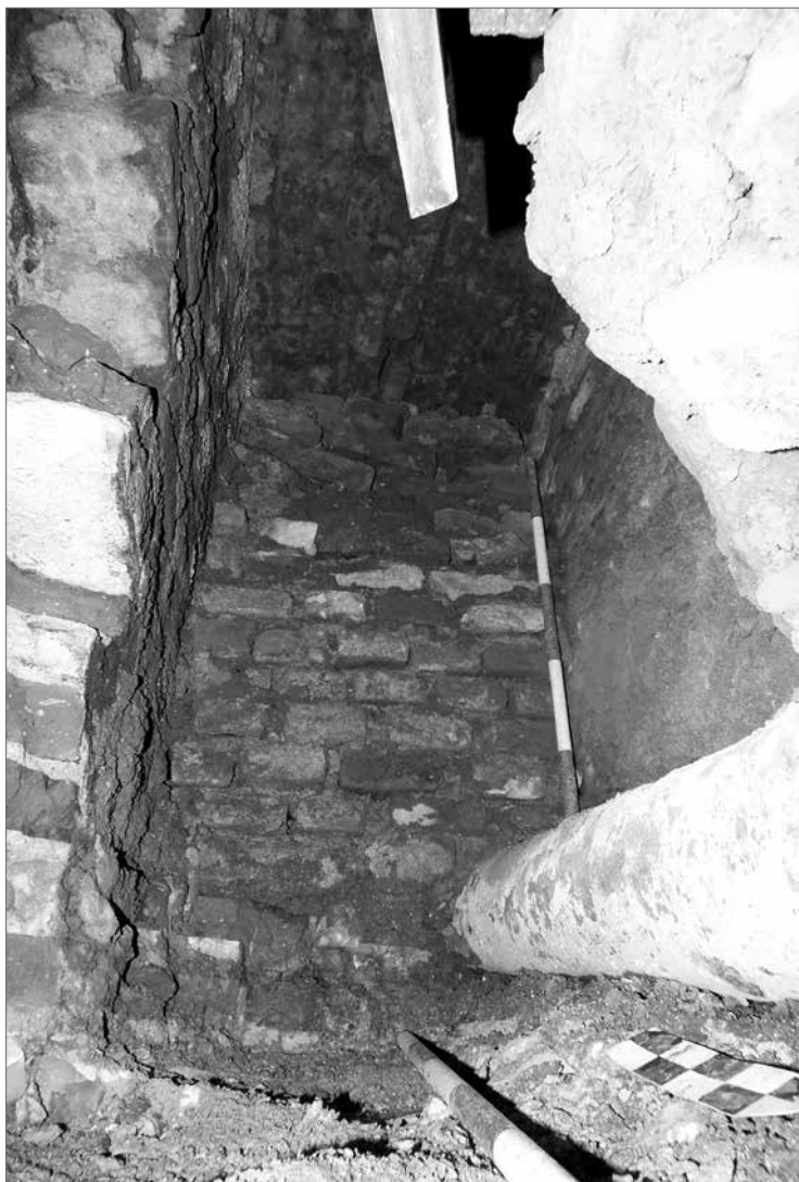
Obr. 16. Platněřská ulice ppč. 1104, snímek prostupu raně barokní kanalizace základovým zdívkem severního křídla jezuitské koleje, pohled k jihu. Cihlami zaklenutý průchod uzavřen v 19. století zazdívkou. Výzkum NPÚ ÚOP v Praze č. 2011/15, vedoucí výzkumu J. Havrda. Foto K. Žďárský.
