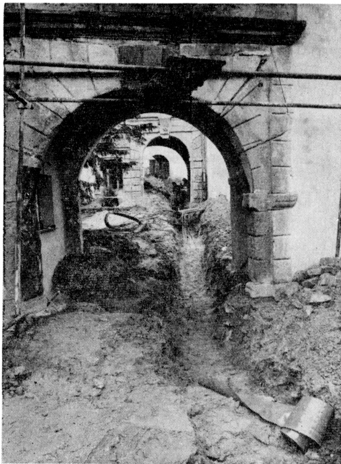
Obr. 1. Hrad Sovinec, výkop pro připojku inženýrských sítí provedený bez archeologického dohledu. Foto OVM Bruntál.
